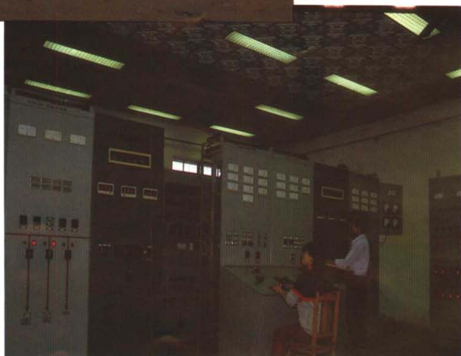
臨清熱電廠控制室
