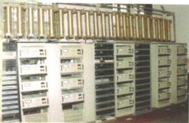
MMDS微波多路电视分配系统(农村有线电视)发射机房
