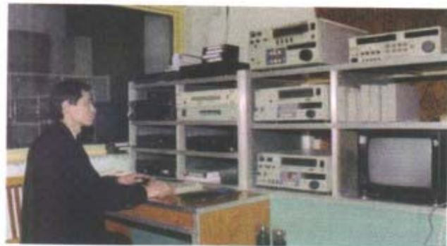
东昌电视台发射机房
